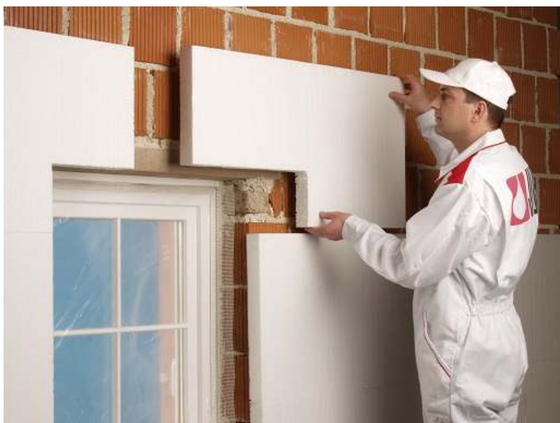
ΔΙΑΜΟΡΦΩΣΗ ΓΩΝΙΩΝ ΛΑΜΠΑΔΩΝ
